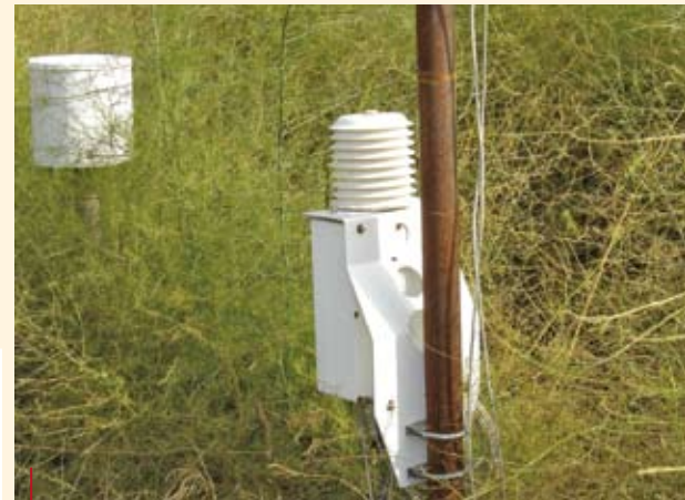
1 Metos-Wetterstation im Bestand auf dem Damm
